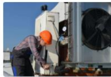
Сервис и техническое обслуживание систем вентиляции и кондиционирования воздуха
